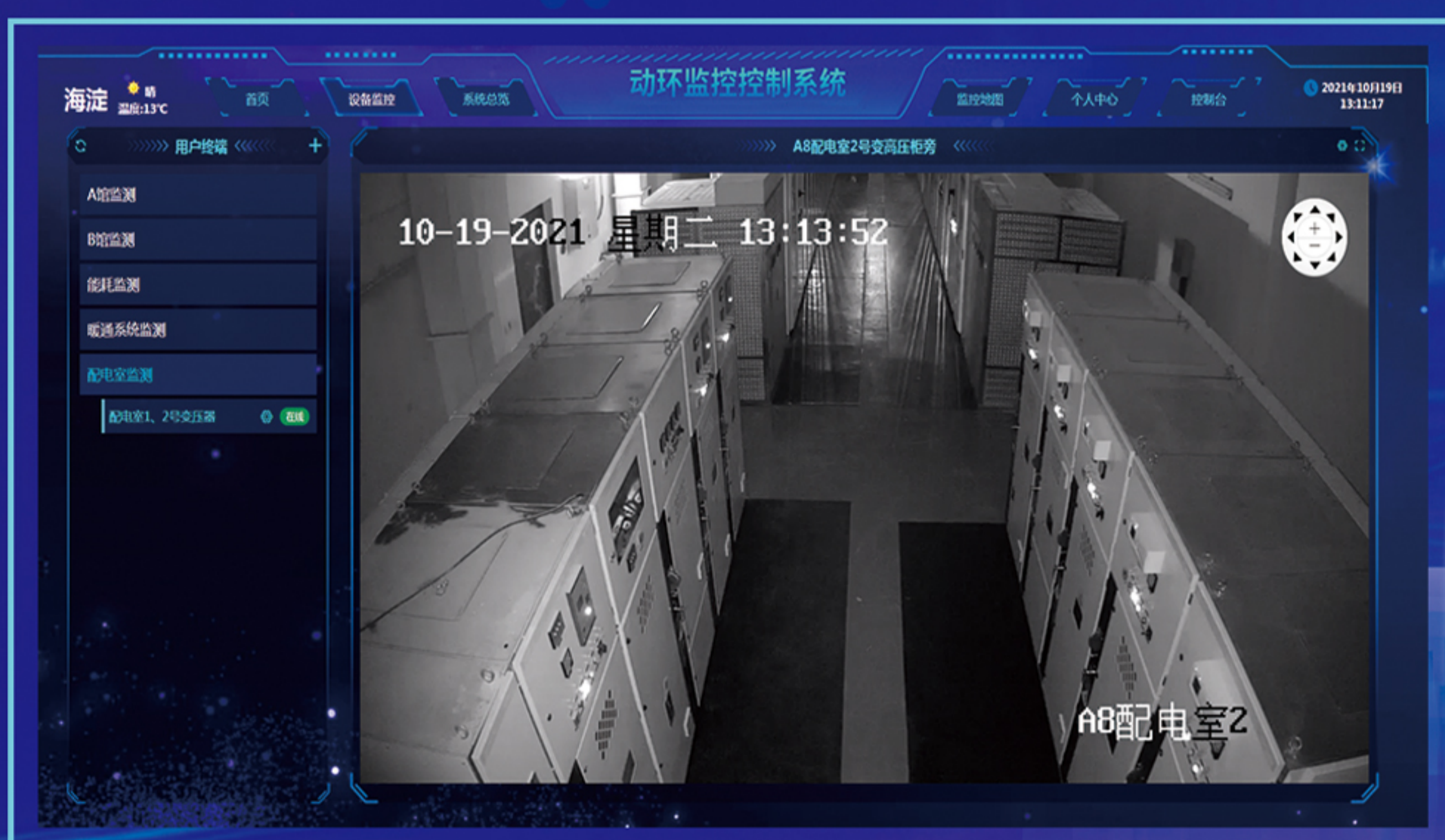
支持视频监控接入，监控数据与视频同步查看
